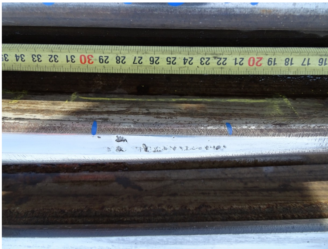
Obrázek 9 - Stav vady 511B před provedeným opravným broušením
