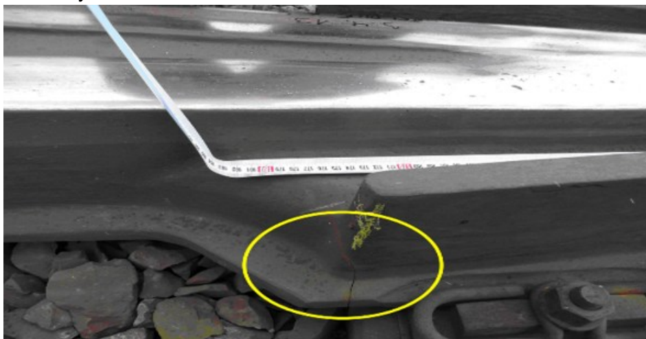
Příčné trhliny na odlitku Kód vady 734V
