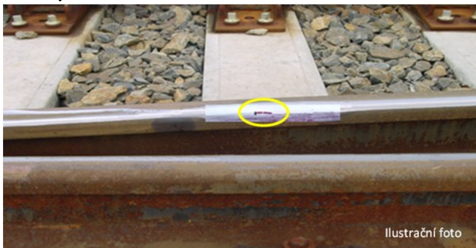
Podélné trhliny na přípojných kolejnicích Kód vady 623N
