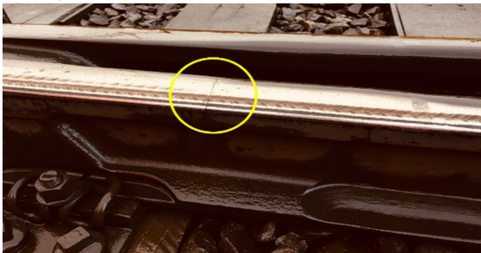
Příčné trhliny na ostatních pojížděných plochách odlitku Kód vady 732V
