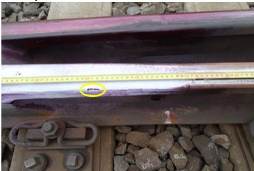
Podélné trhliny na ostatních pojižděných plochách odlitku Kód vady 622N
